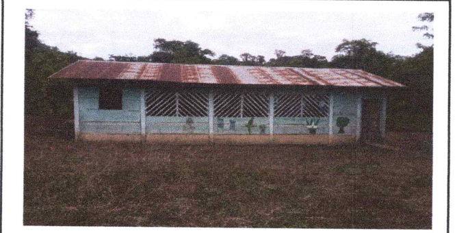
Foto 3: Pared de madera y puerta ya deteriorado.
